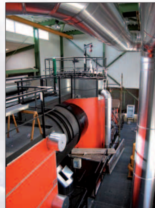
Det nye varmeværk, interior 2008.
